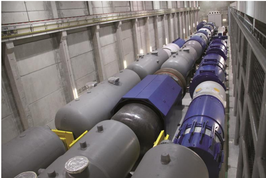
Abb. 4.1: Abklinglagerung von Großkomponenten im Zwischenlager Nord in Lubmin (Quelle EWN)
